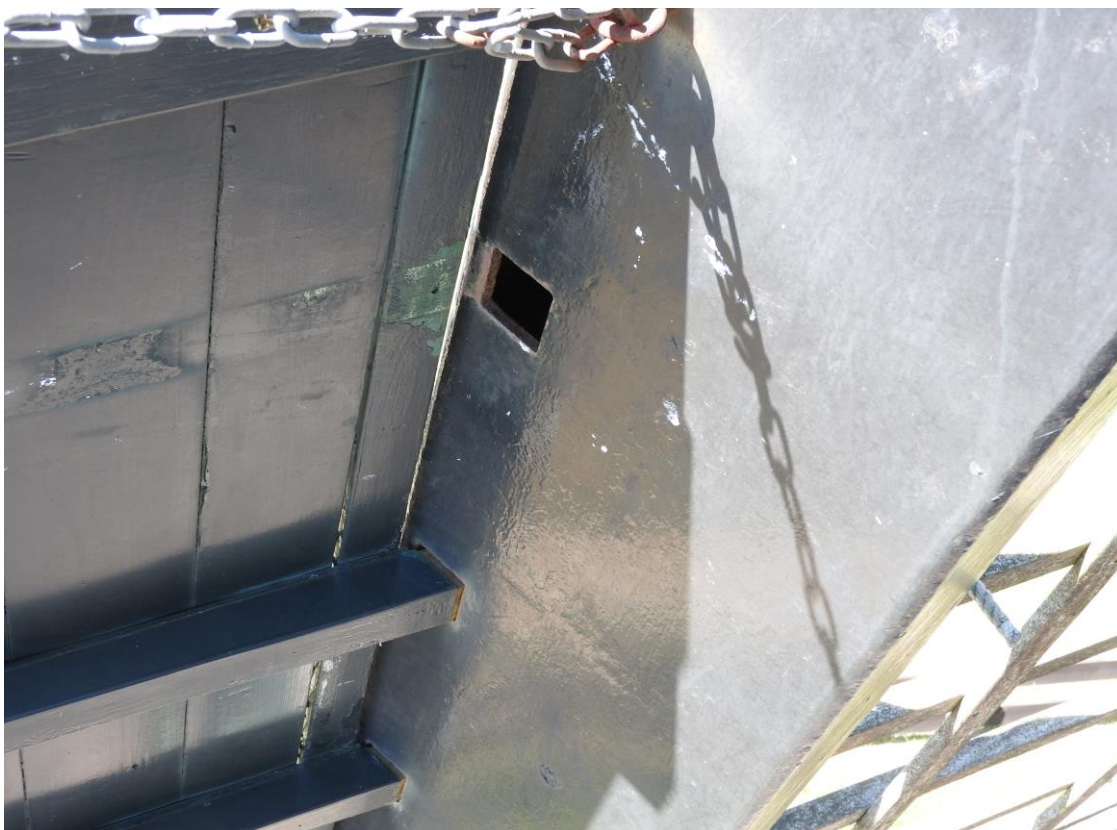
Foto 6: Detail van de uitgenomen hekstok t.b.v. het inspecteren van de binnenzijde.
