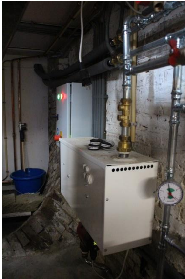
Elektrische cv installatie met op de achtergrond de regelenheid van de generator.
